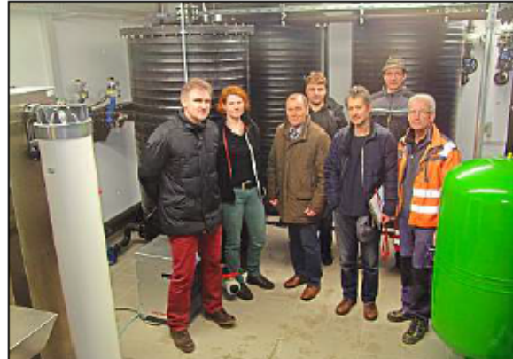
An der jüngsten Kontrolle des neuen Hochbehälters durch Mitarbeiter des Gesundheitsamtes Regen nahmen teil: (v.l.) Lothar Penn und Marlene Hackl vom Gesundheitsamt, Bürgermeister Hermann Brandl, Wolfgang Augenstein von der Firma Schwarzkopf Wassertechnik, Planer Karl Meier und die Wasserwarte Markus Spannagl und Hans Reith. – Foto: Reith
